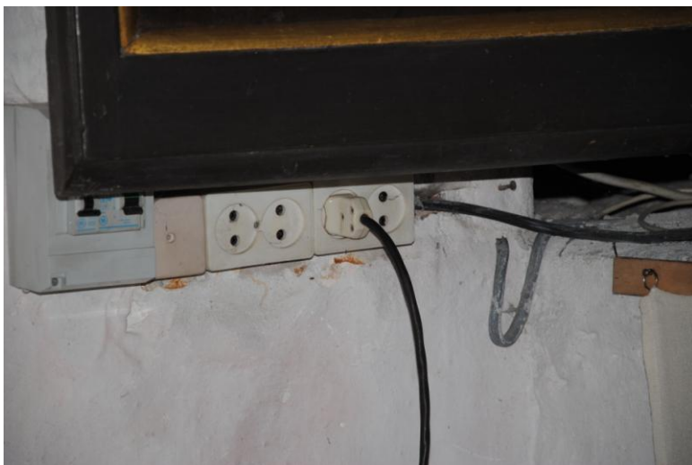
Foto 8 Hoone elektrijuhtmistiku seisukord
