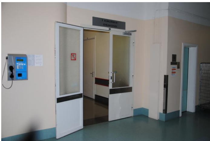
Foto 5 Tuletõkkeseksiooni avatud asendisse fikseeritud uks
